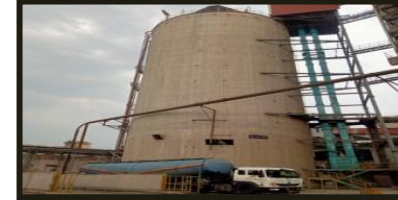
Fly Ash Silo
